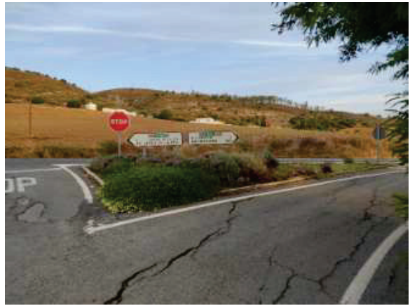
Entrada Michelin en muy mal estado, posible obra.
